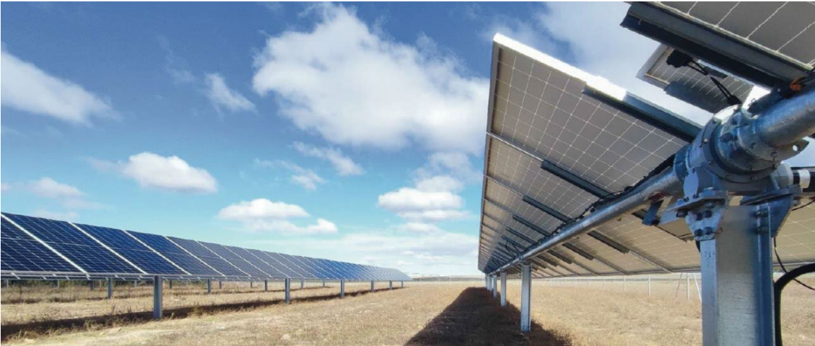
Figura 6. Exemple d'estructura de panells fotovoltaics amb seguidor
