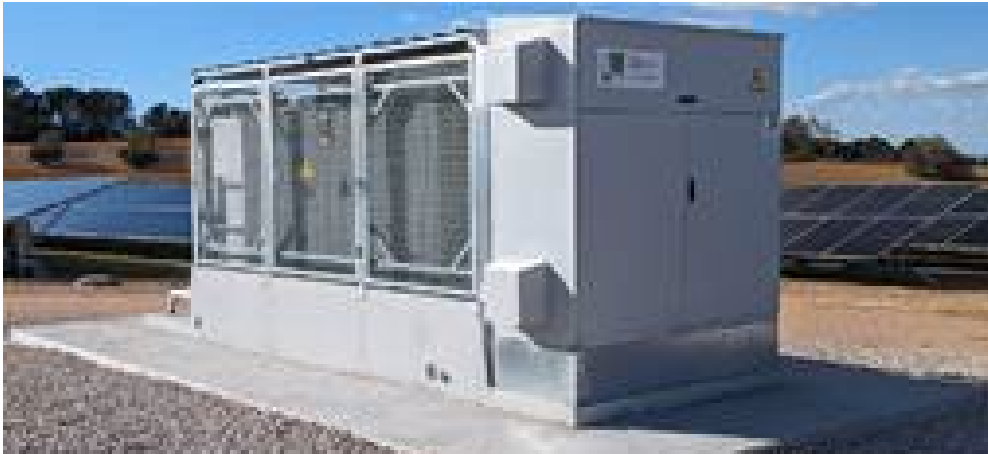
Figura 8. Exemple de Centre de Transformació 25/0,8 kV de 1,9 MVA de potència
